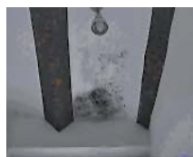
Point froid provoquant la condensation et le développement de moisissures.
