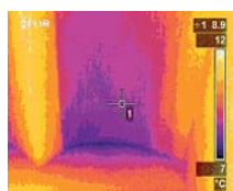
Thermographie infrarouge identifiant les différences de températures d'un plafond et les ruptures d'isolation
